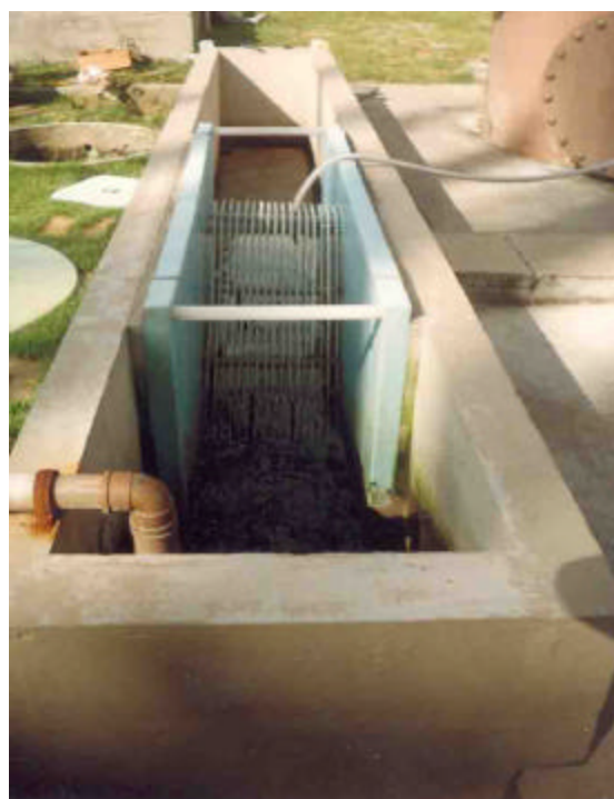
Figura 4.4 – Tratamento preliminar: grade de barras e desarenador tipo canal
