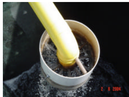
Figura 4.11 – Detalhe do dispositivo de alimentação da unidade de decantação.
